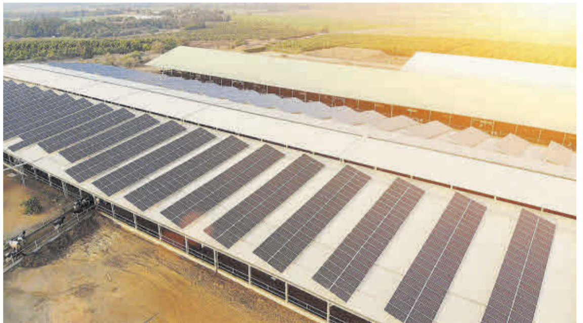
Sistema de generació d'energia fotovoltaica instal·lat a la teulada d'una granja lletera. FOTOVOL
